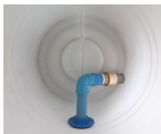
Ubicación del sistema de filtrado al interior del estanque
