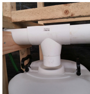
Canaleta de recepción de agua sobrante con retorno al estanque acumulador
