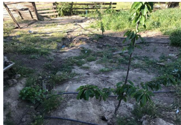
Sistema de riego presurizado con bomba alimentada con paneles solares, Empedrado
