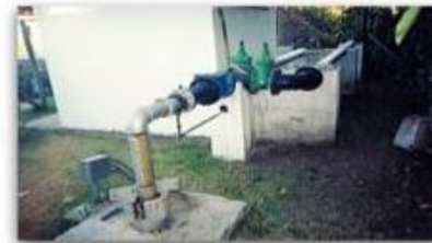
Electrobombeo para Riego
