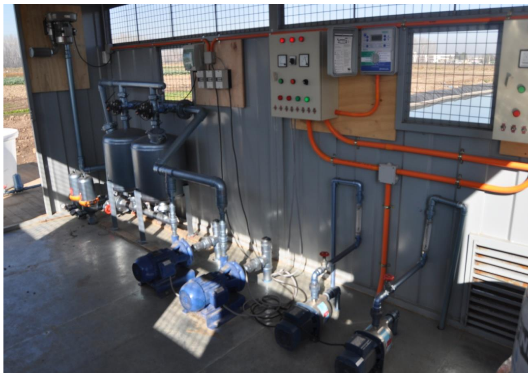
Bombas y filtros
